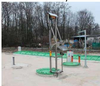
^ Oczyszczalnia ścieków Kaleń
